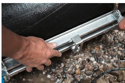
Installation sans interruption de l'alimentation
