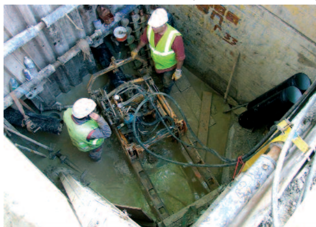
Forage guidé à la tarière pour la mise en place d'une canalisation d'assainissement gravitaire (Patrice SCHNEIDER - FSTT)
