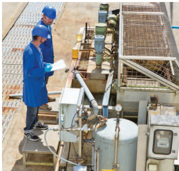
Unité de traitement physico-chimique
