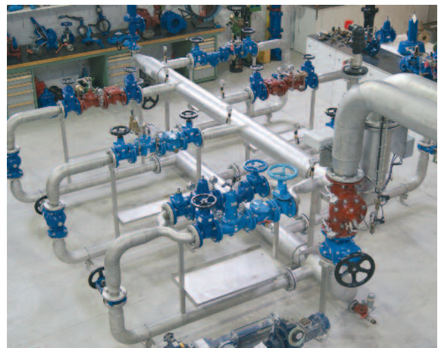
Banc d'entraînement à la régulation hydraulique
